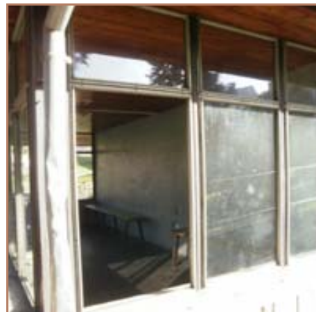
Rozbitá okna u čekárny na náměstí. Komu vadila?
